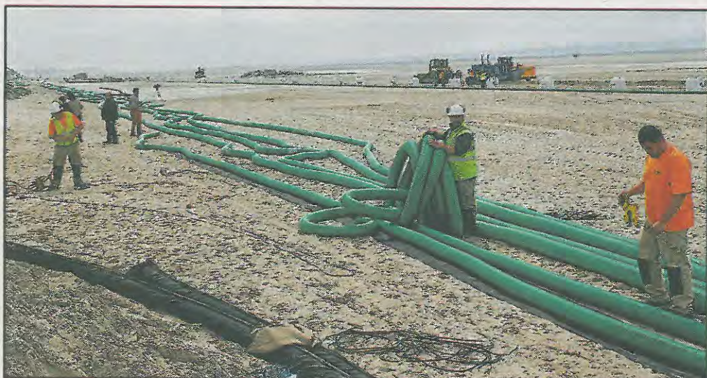
Les premiers drains ont été enfouis à environ deux mètres de profondeur sur 900 mètres linéaires.
