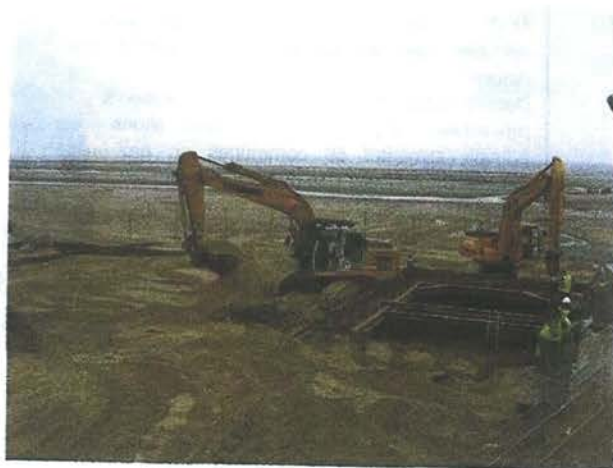
La station de pompage collectera et rejettera l'eau à la mer.
