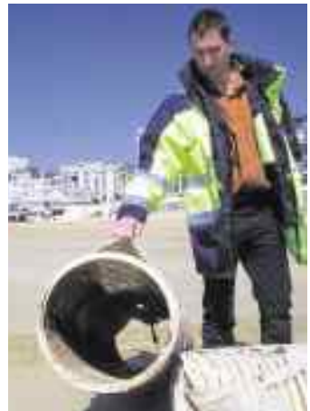
En creusant une piscine aux abords de l' Artemis pour faciliter sa remise à flot, les pelleteuses avaient éventré un des quatre drains enterrés sous la plage. La portion endommagée a été remplacée mercredi.
